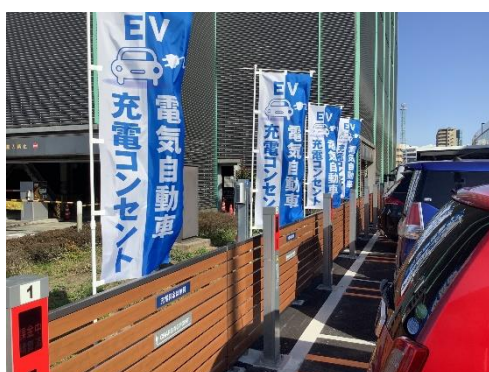
充電器設置状況
